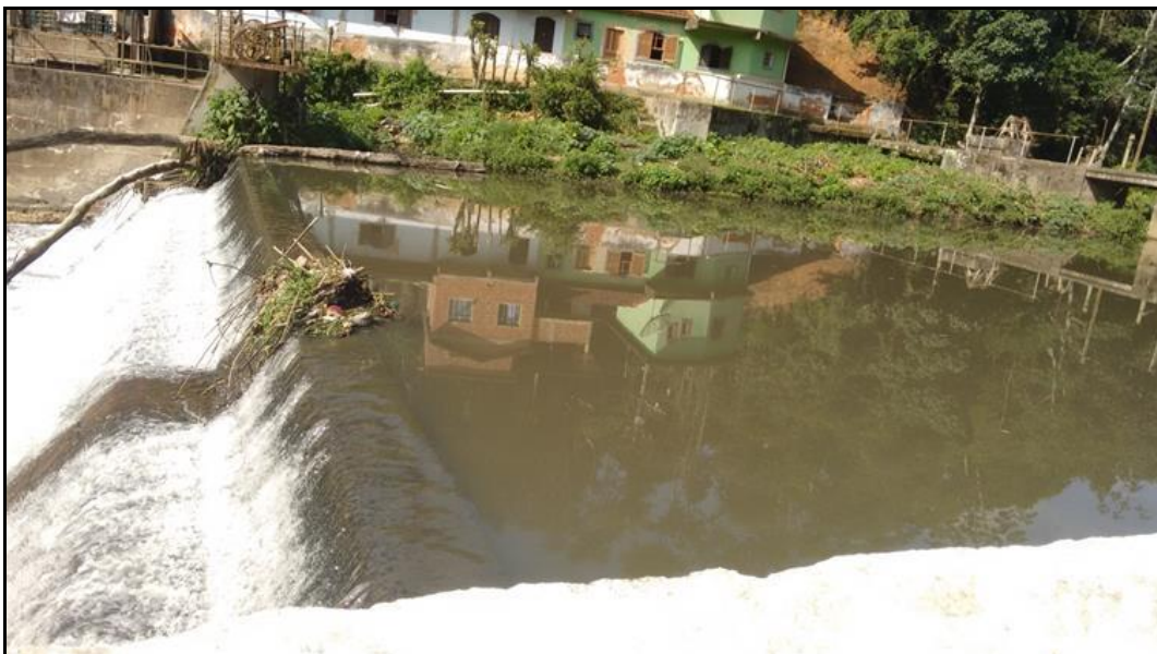
Figura 3.38: Detalhe do tronco de árvore e resíduos presos na crista barragem. Fonte: Foto pessoal de 22 de janeiro de 2015
