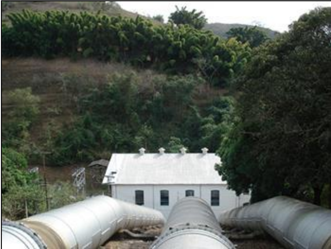
Figura 3.34: Atual tubulação de adução. Fonte: Foto pessoal de 16 de abril de 2013.
