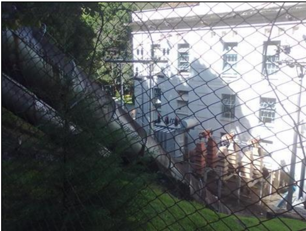
Figura 3.19: Tubulação entrando na Casa de Máquinas. Fonte: Foto pessoal de 16 de abril de 2013.
