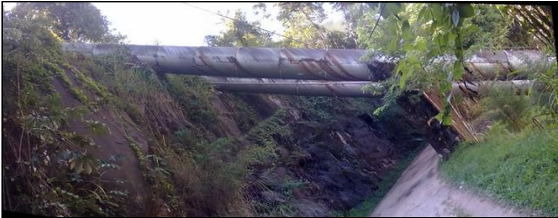
Figura 3.18: Tubulação que chega à usina. Fonte: Foto pessoal de 16 de abril de 2013.
