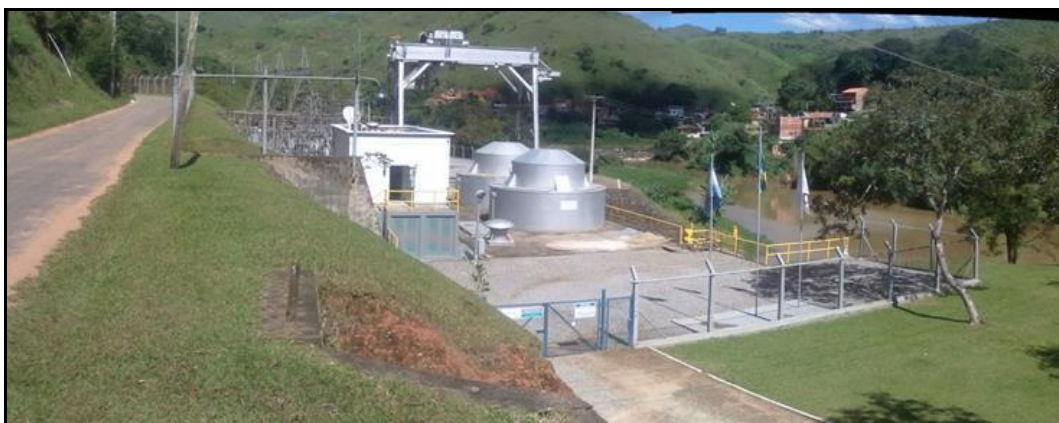
Figura 3.25: Vista da Casa de Força e Subestação da PCH Areal. Fonte: Foto pessoal de 16 de abril de 2013.
